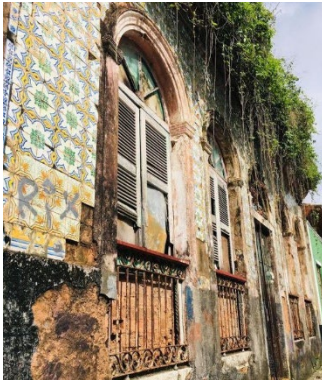
Figura 5 – Edificação em ruína
