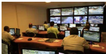
SISTEMA DE VIDEOMONITORAMENTO
